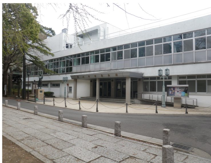
今年4月からホールが天井崩落の危険があると判断し、使用が中止されている市川市民会館
